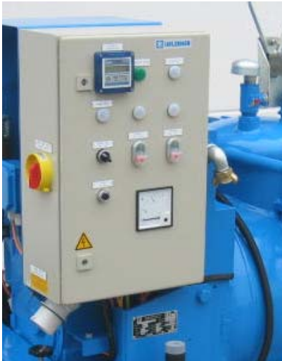
Elektrische Steuerung mit Wasserdosiereinheit und Potentiometer für Mischzeiteinstellung
